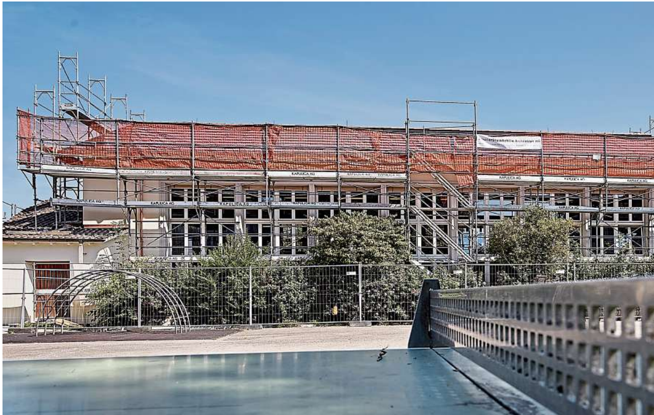
Abdichtung ging vergessen. Wasser drückt durch die Wände im Untergeschoss der Turnhalle. Es feuchtet. Foto Jérôme Depierre
